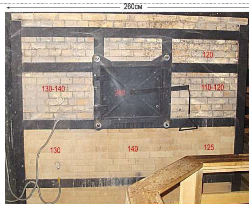
Фото 8. Температуры на поверхности печи: 110-140°
